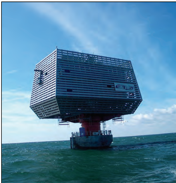
Figur 15 Exempel från på transformatorstation (Nystedt, Danmark) Källa: STOAB
