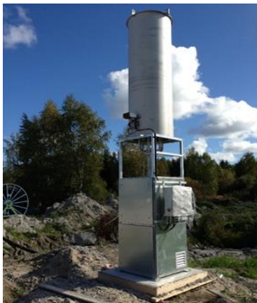
Kuva 24. Jepuan laitoksen soihutpolttin
