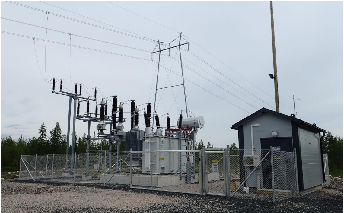
Kuva 15. Esimerkki tuulivoimahankkeen sähköasemasta (kuva Minna Takalo/FCG).
