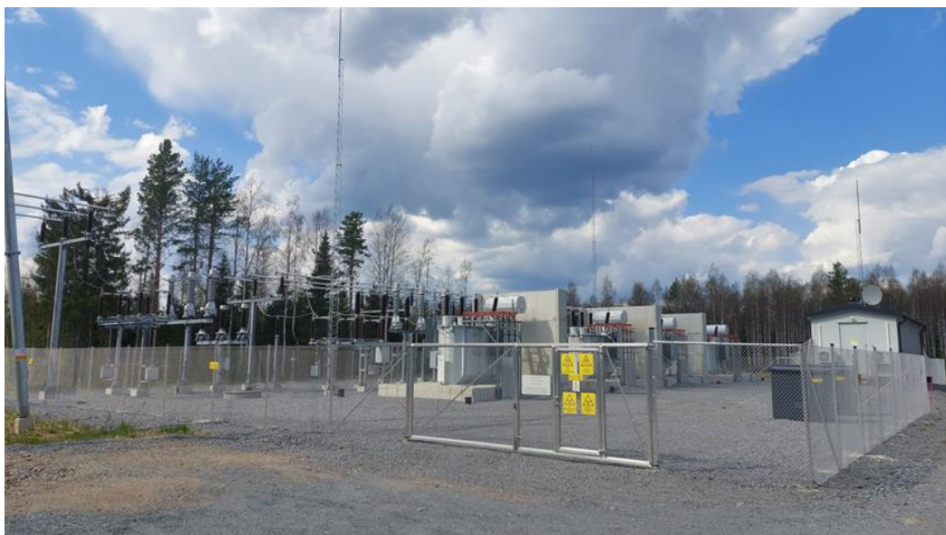
Kuva 12. Esimerkki tuulivoimapuiston sähköasemasta (Väläkankaan tuulipuisto, Haapajärvi).
