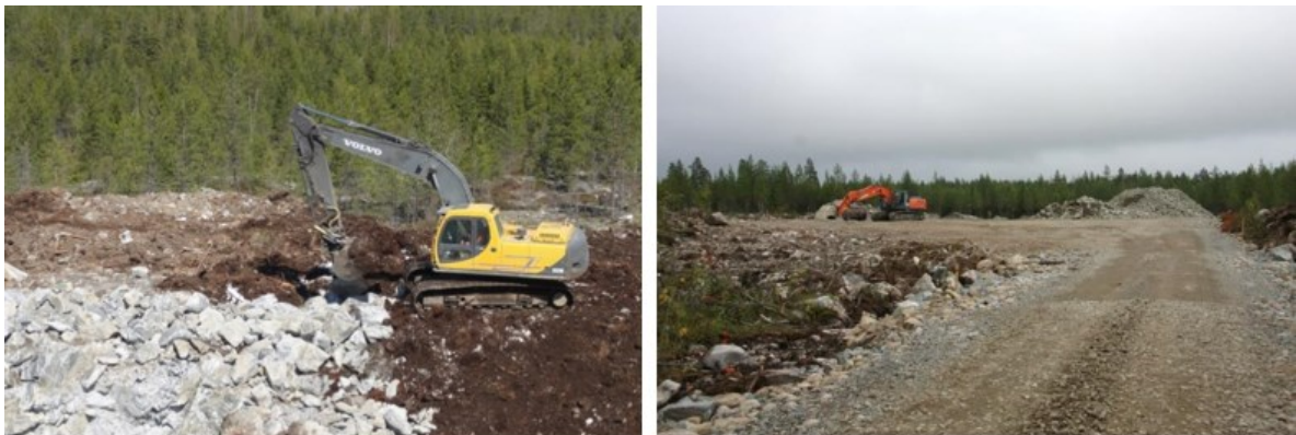
Kuva 5.11 Tuulivoimapuiston rakentaminen alkaa huoltoteiden ja pystytysalueiden rakentamisella (FCG Finnish Consulting Group Oy).
