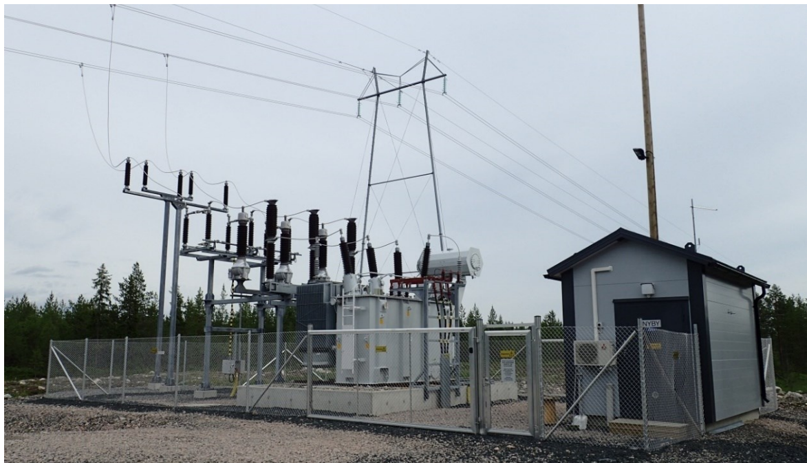
Kuva 5.8 Esimerkki tuulivoimapuiston sähköasemasta (FCG Finnish Consulting Group Oy).
