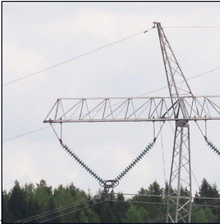
Kuva 107. Voimajohtopylvään eristimiä, joissa koronapurkauksia voi esiintyä.
