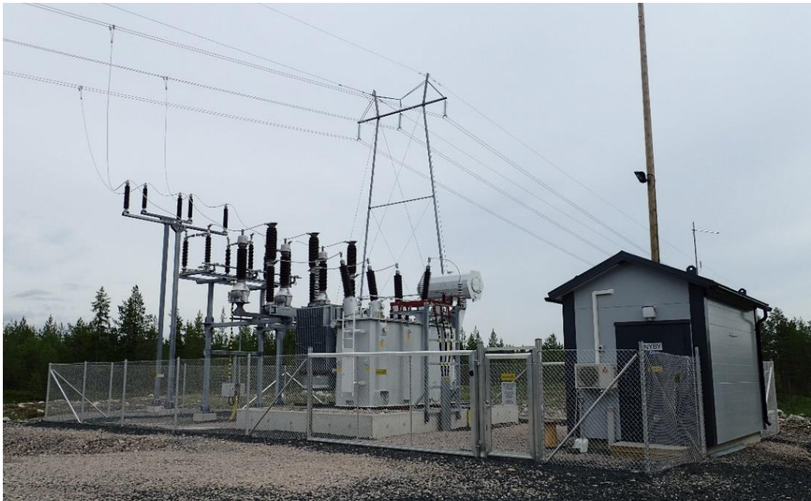
Kuva 3-10. Esimerkki tuulivoimapuiston sähköasemasta.
