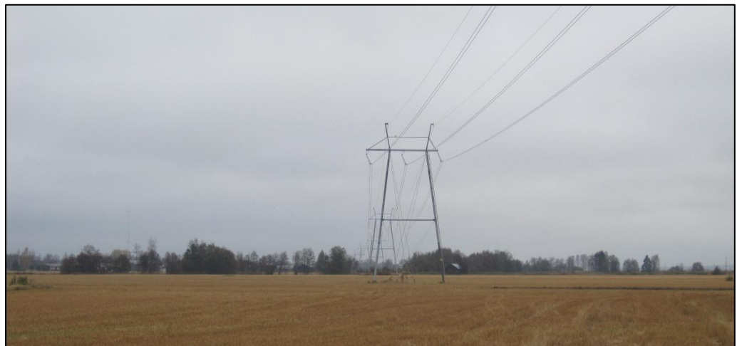
Figur 13. Exempel på en 110 kV luftledning med stagade portalstolpar.
