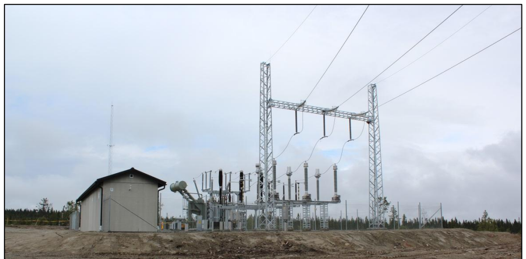
Figur 12. Exempel på en 64 MVA elstation.
