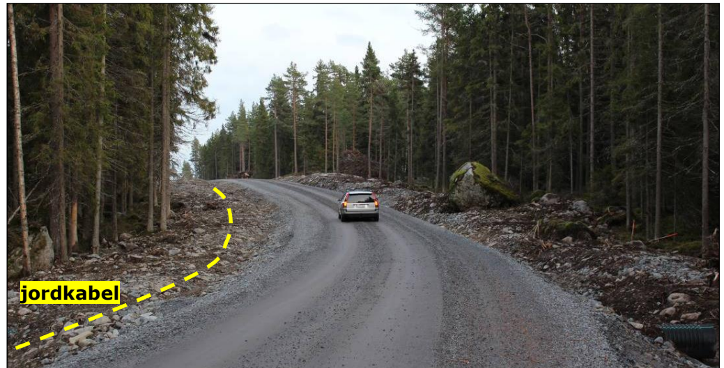
Figur 11. Exempel på väg för transport av vindkraftsverk och placeringen av elöverföringskabeln i samma linje med vägen.
