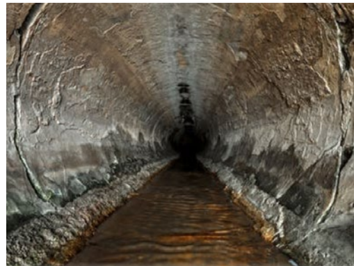
2. KÉP: Savkorrózió okozta károsodás csatornában
