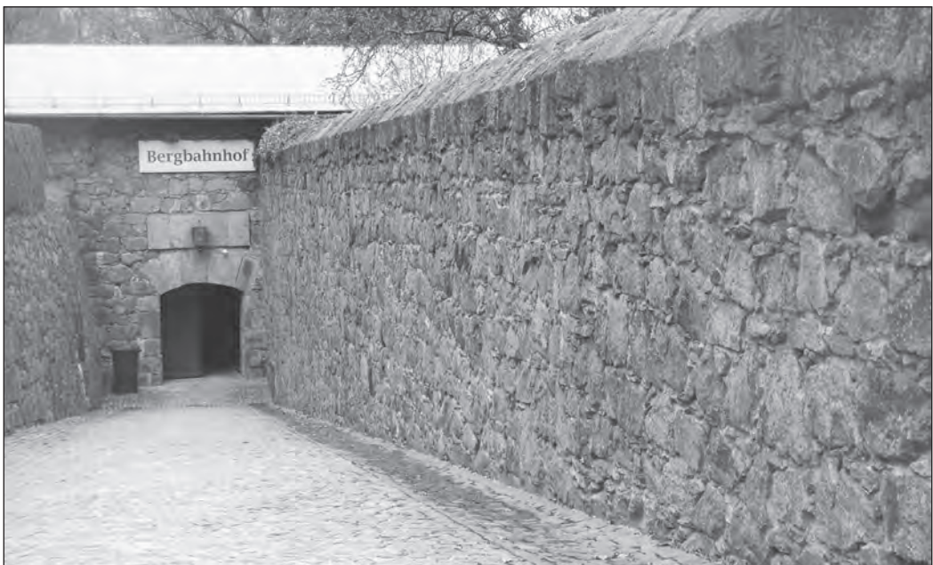
Abb. 13: Die etwa 60 Jahre alten Mauern am Eingang der Bergstation der Pöstlingbergbahn beherbergen eine Fülle von kleinen Krustenflechten.
