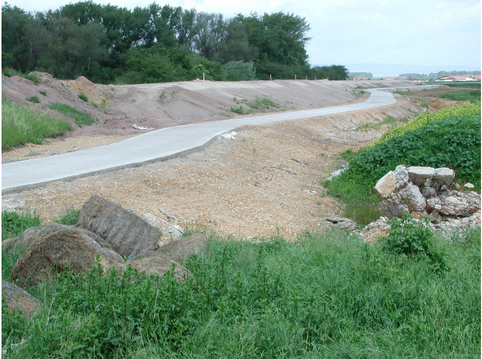
Abbildung 9: Zerstörung von Iris-spuria -Wuchsorten. Vollständige Umgestaltung der landseitigen Deichböschung zwischen Kornsand und Astheim; 24. Mai 2006.
