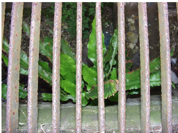
Abb. 4: Hirschzunge ( Asplenium scolopendrium ) in einem Kellerschacht (T. KASIELKE).
