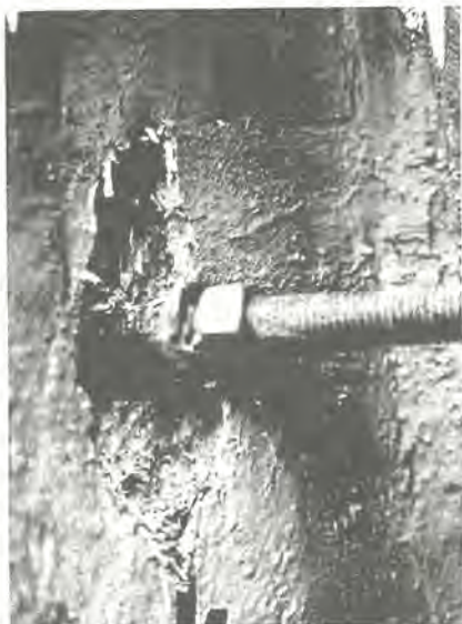
Abb. 2: Verstärkte Fäule am Gewindestab – trotz Wundverschluss.
