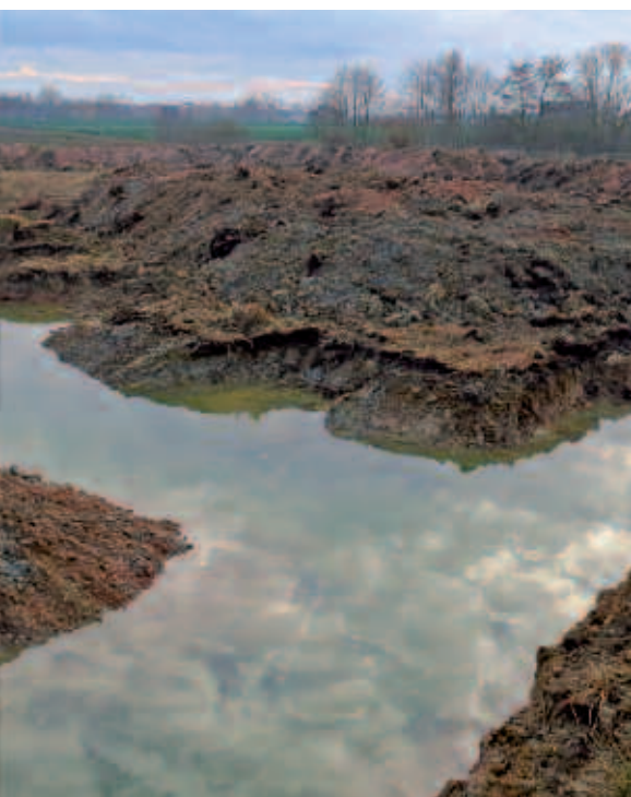
Abb. 7: Aushub wird zu wertvollen Rast- und Brutinseln aufgetürmt. (Foto: K. v. Nida)
