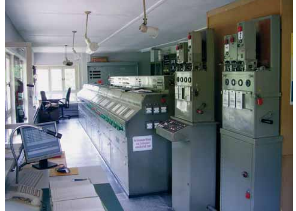
Auch nach 75 Jahren werden im elektromechanischen Stellwerk in Pirmasens Nord die Signale und Weichen zuverlässig von Hand gestellt. Der Computer ist ein ergänzendes Informationsmedium – die Aufschreibungen über den Zugverkehr werden noch immer von Hand getätigt. Auch die links unten sichtbare Telefonanlage ist fast museumsreif. (Aufnahme Sammlung Herbert Justus)
