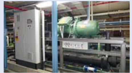
Wassergekühlte L&R Kältemaschine
