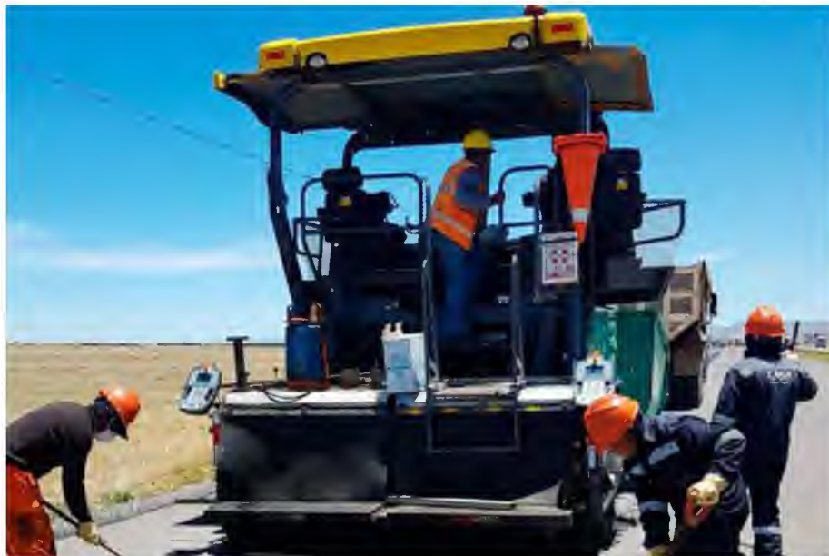
En cumplimiento de nuestro rol de fiscalización y frente a las deficiencias advertidas en la Obra "Segunda Calzada de la Carretera Puno – Juliaca".
