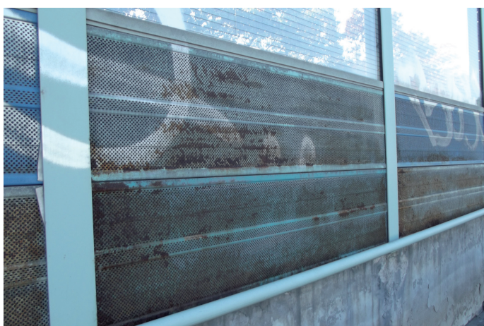
Fot. 2. Korozja paneli i degradacja fundamentu ekranu (foto: Dariusz Zaród)
