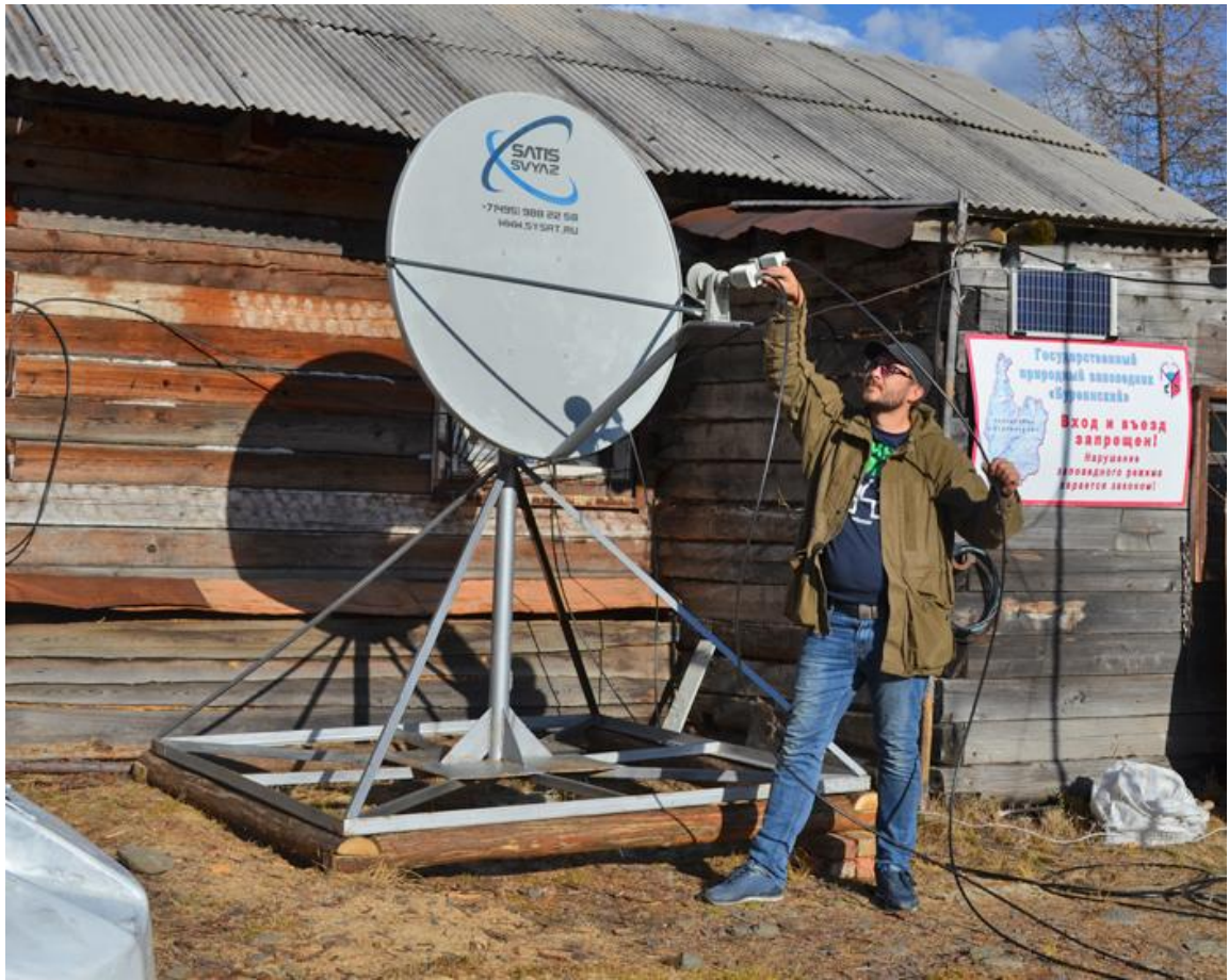
Рис. 22. Установка оборудования связи на кордоне «Ниман» Буреинского заповедника
