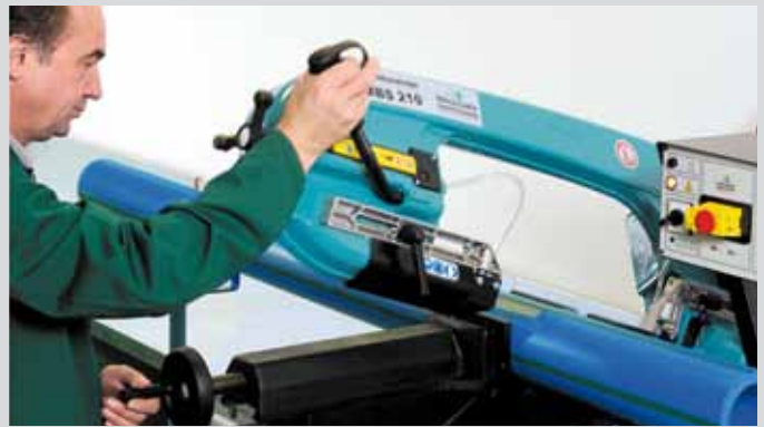
Antes de la soldadura se corta el tubo hasta la longitud deseada
