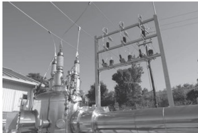
Σχήμα 2.34: Εγκατάσταση HTS καλωδίου σε επίπεδο μέσης τάσης στην περιοχή Albany της Νέας Υόρκης. Το πρόγραμμα ήταν σύμπραξη των εταιρειών Super Power και Sumitomo.
