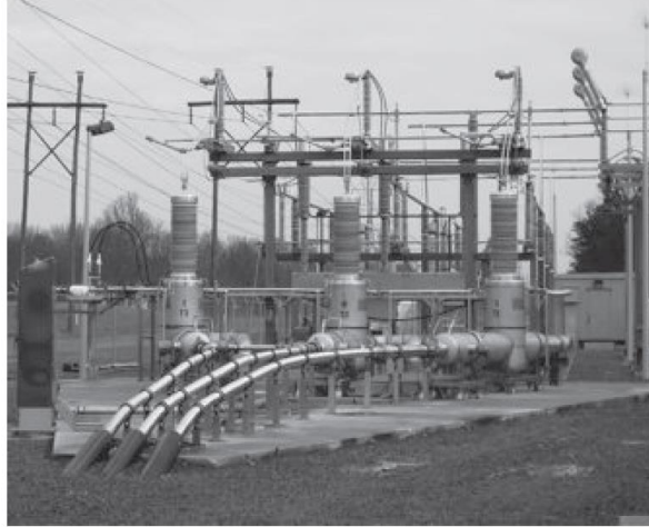
Σχήμα 2.33: Εγκατάσταση HTS μονοφασικού αγωγού στο Long Island της Νέας Υόρκης από τις American Superconductor και Nexans.
