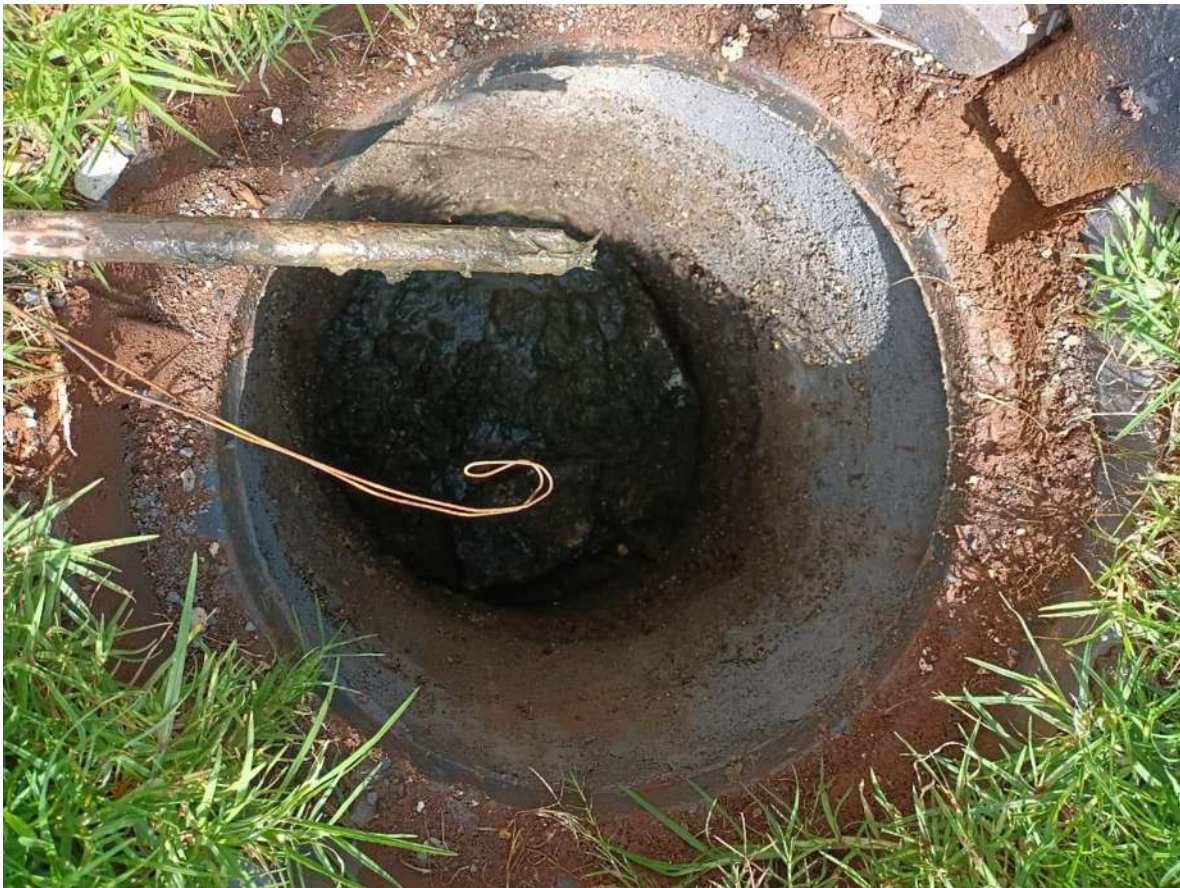
Figura 26. Alcantarillado con solidos acumulados
