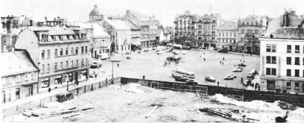
So sieht es jetzt am Marktplatz in Tetschen a. d. Elbe nach der Sprengung des Hotel Prag aus (Aufn. 1967).
