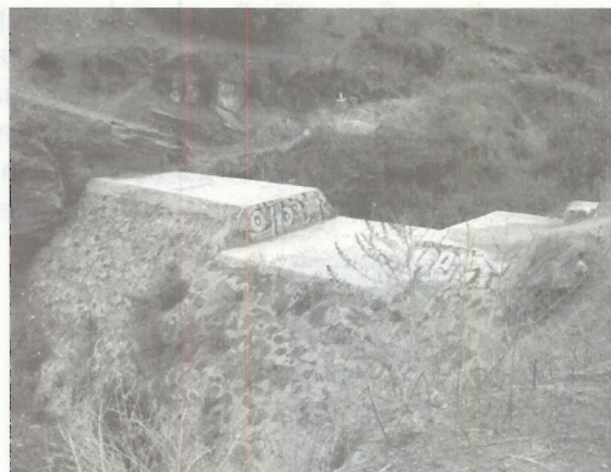
Fig. 38. Presa reguladora de avenidas (rompe-picos).
