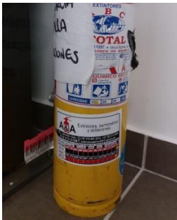
FOTOGRAFÍA 3. EXTINTOR GRUPO INTERNO DE TRABAJO ASESORIA Y PRODUCCIÓN NORMATIVA
