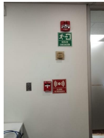
FOTOGRAFÍA 48. SEÑALIZACIÓN PARA CASO DE EMERGENCIA
