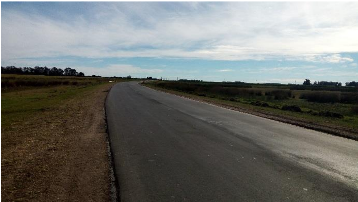
Figura 7. Ruta Provincial N° 75. Capa de arena asfalto
