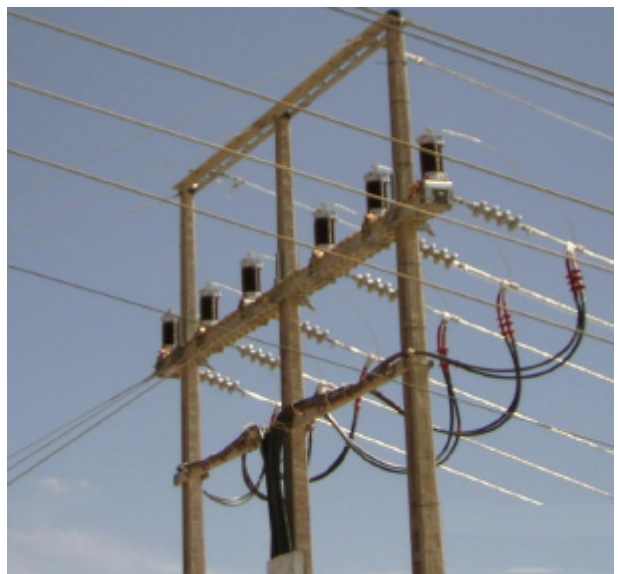
Estructura de remate línea 2x23kV. Compañía Minera Doña Inés de Collahuasi.
