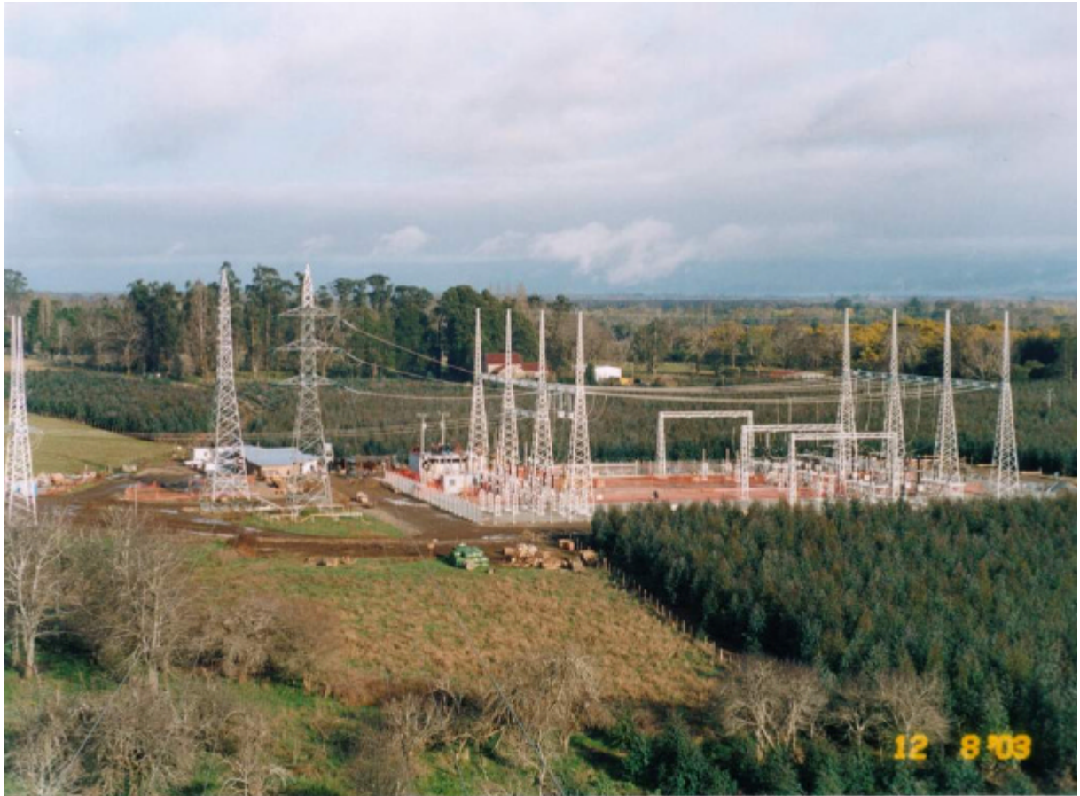
Subestación de maniobra Ciruelos, línea 220 kV. (Celulosa Arauco a S.I.C.).
