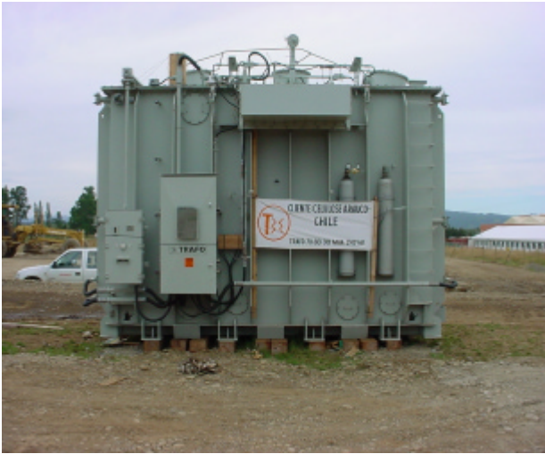
Transformador de poder en subestación de transformación Celulosa Arauco.
