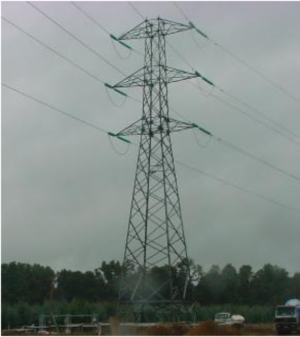
Estructura de anclaje línea 2x220 kV. S.I.C.
