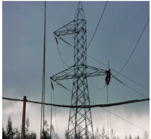
Estructura circuito simple 220 kV. (Celulosa Arauco).
