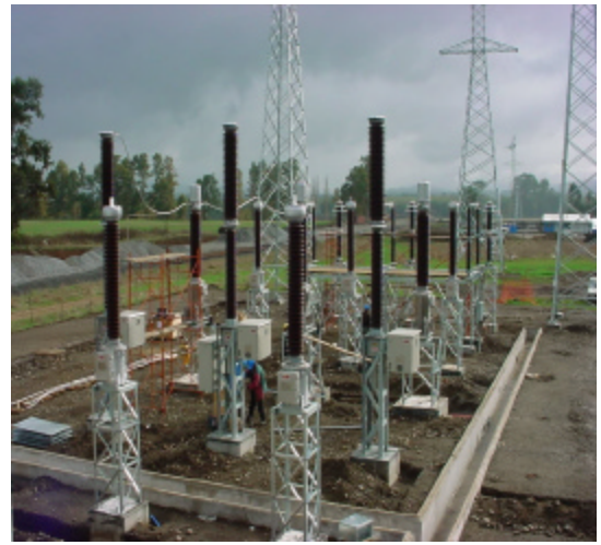
Estación de transformación Celulosa Arauco.
