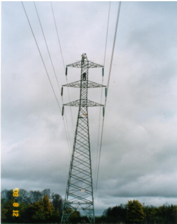
Estructura de suspensión línea 2x220 kV. S.I.C.
