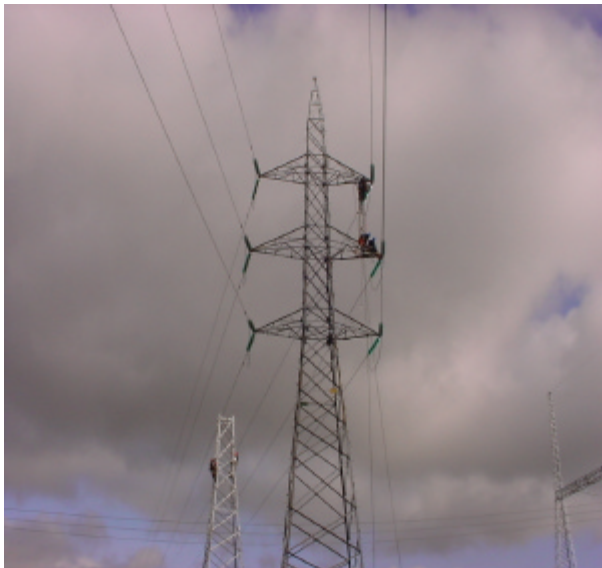
Estructura doble circuito 220 kV. (Sistema interconectado central S.I.C.).
