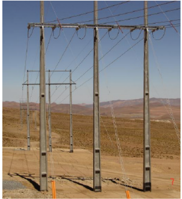
Estructura de anclaje línea 2x23kV. Compañía Minera Doña Inés de Collahuasi.
