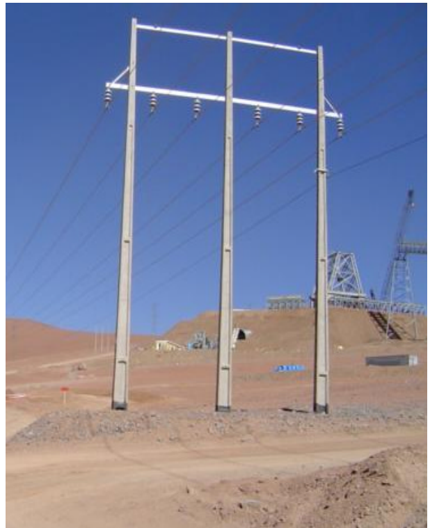
Estructura de suspensión línea 2x23kV. Compañía Minera Doña Inés de Collahuasi.
