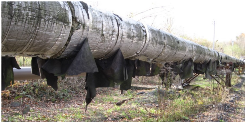
Obr. 11 Poškozená izolace potrubí, ukradeno oplechování. Foto autor.
