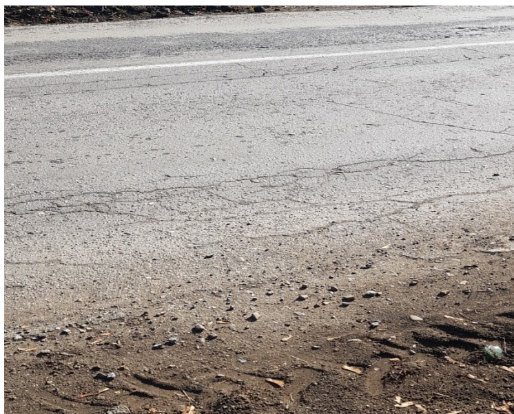
Рисунок 1 – Руйнування дорожнього одягу через два роки після ремонту
