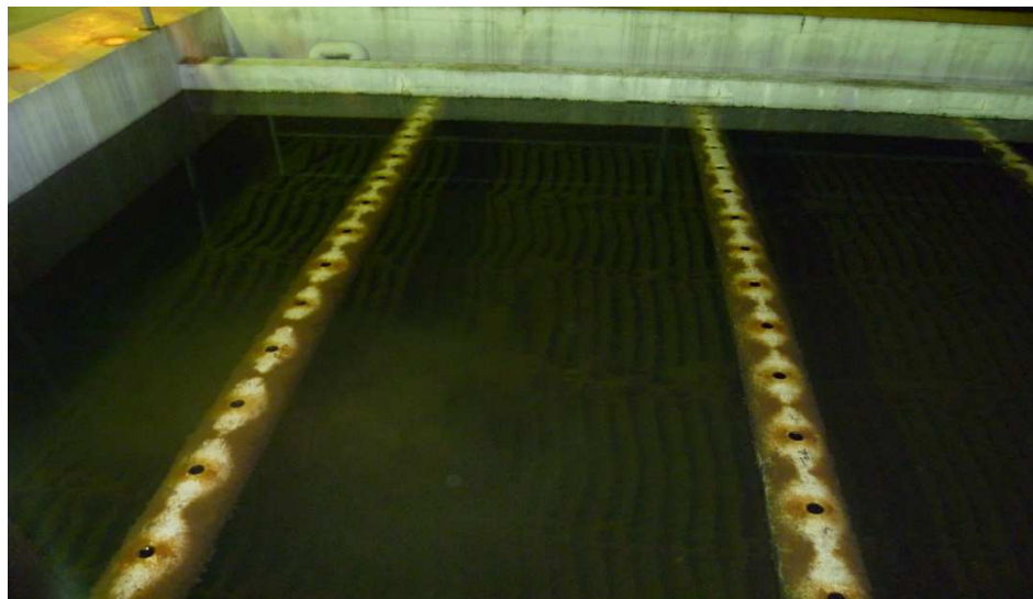
Figura 3.2 Estado del sedimentador previo a su lavado
