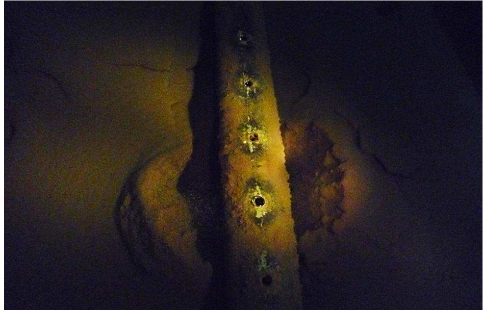
Figura 3.3 Colmatación de las unidades de sedimentación
