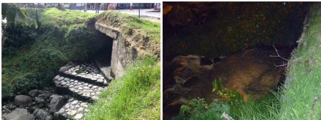
Figuras 3.5 y 3.6 Sitio de descarga del efluente de la Planta de El Cebollar y su posterior salida sobre el Río Tomebamba.
