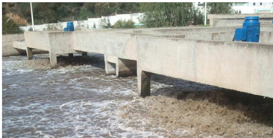
Figure II.6. Brassage et aération des eaux
