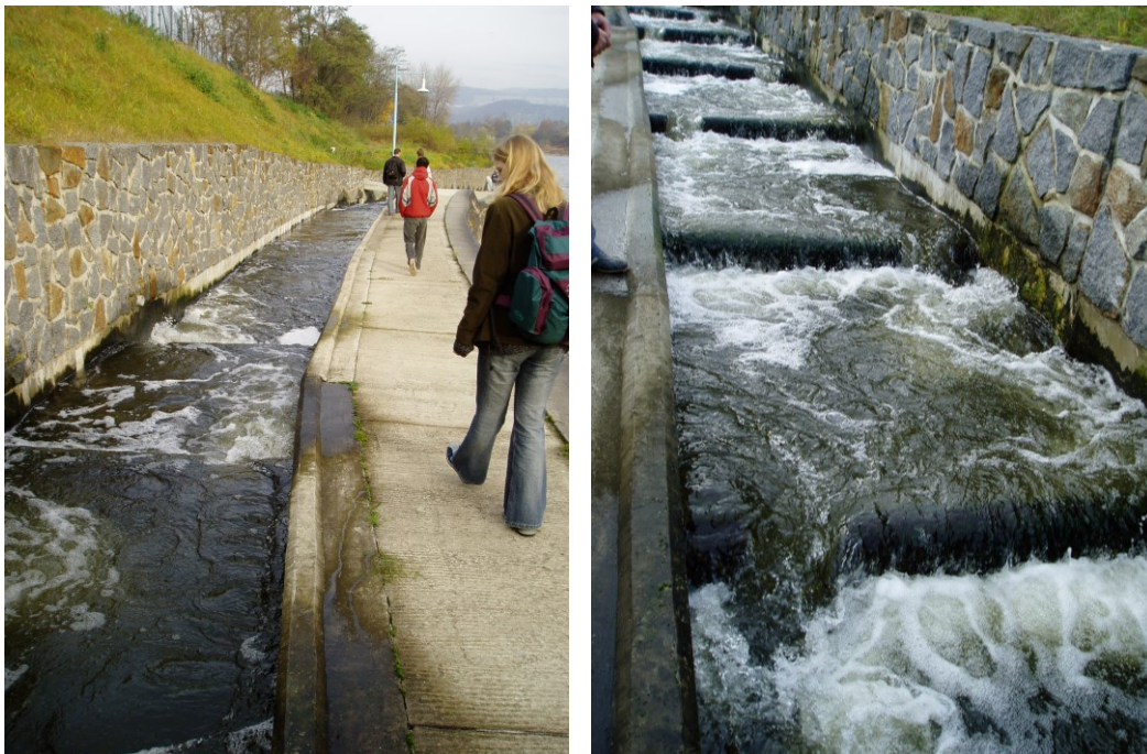
Obr. 18 Komůrkový rybí přechod na Labi na zdymadle Střekov (Ústí nad Labem)
