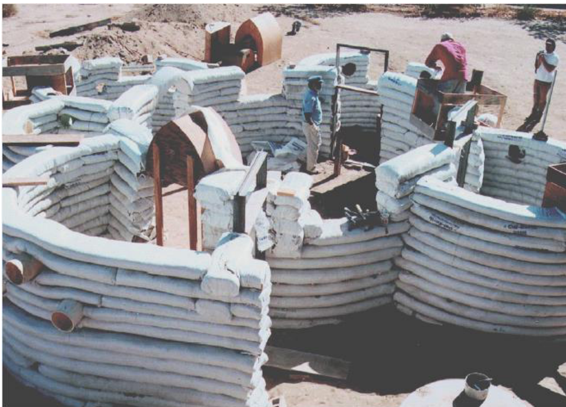
Figura 19. Vivienda de súper adobe en construcción en California por un equipo de Nader Khalili, Instituto de California del arte y de la arquitectura de la tierra. (Fuente http://www.earthbagbuilding.com , Red de Desarrollo Aga Kahn)
