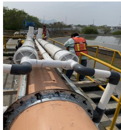
Figura 33. RAFA con tubería adherida
