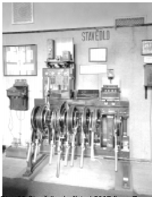
Obr. 22 Stavědlový přístroj 5007 firmy Zeman
