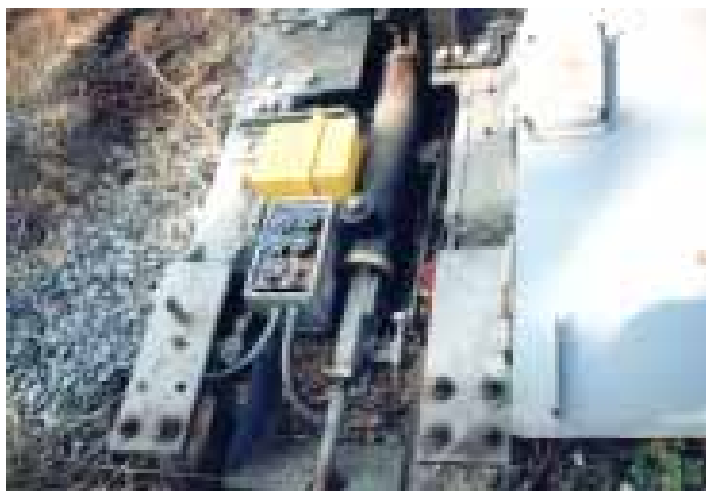
Obr. 41 Samovratný přestavník AŽD ve stanici Stupno
