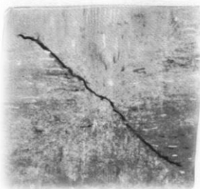
Obr. 13.17: Diagonální trhliny u blokového předlitku
