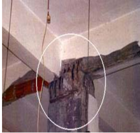
Resim 3.2: İki yönlü kolon-kiriş birleşmesi (hatalı inşa örneği)
