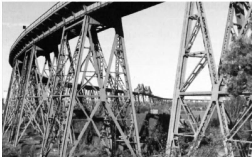
Fig. 23. The railway bridge at Rendsburg built 1911-1913. Courtesy Wasser- und Schifffahrtsverwaltung (WSV) Germany.
