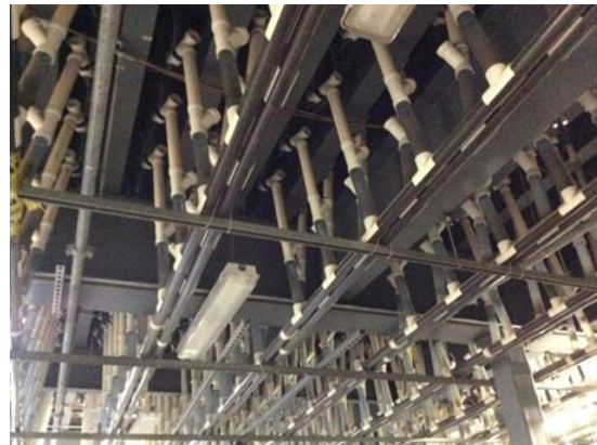
Sistema de tuberías y válvulas
