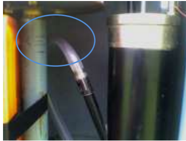
Figura 2.15 Manguera de drenaje.
