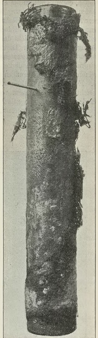
Abbildung 6. Schmiedeisernes Rohr, Aul- hausen; beginnende Zerstörung.
