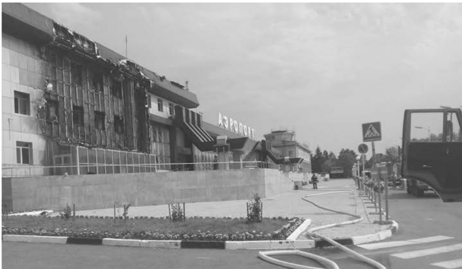
Рисунок 2 – Термические повреждения наружной отделки здания аэропорта г. Благовещенска [7]
