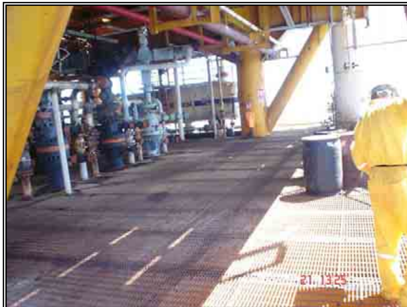
Fotografía VIII. 2. Espacio libre donde se propone instalar la trampa de diablos en la plataforma de Abkatun-B.
