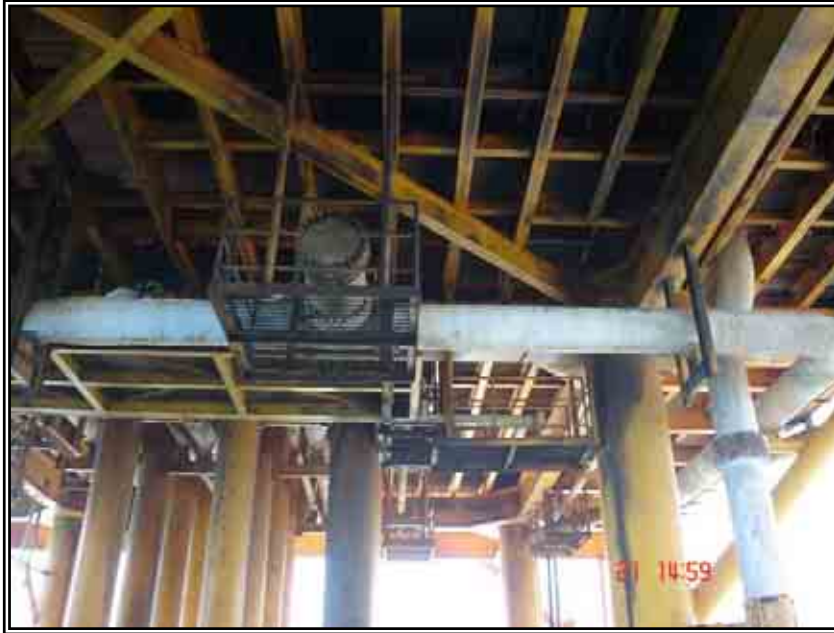
Fotografía VIII. 3. Vista del cabezal de producción de la plataforma satélite Abkatun-B.
