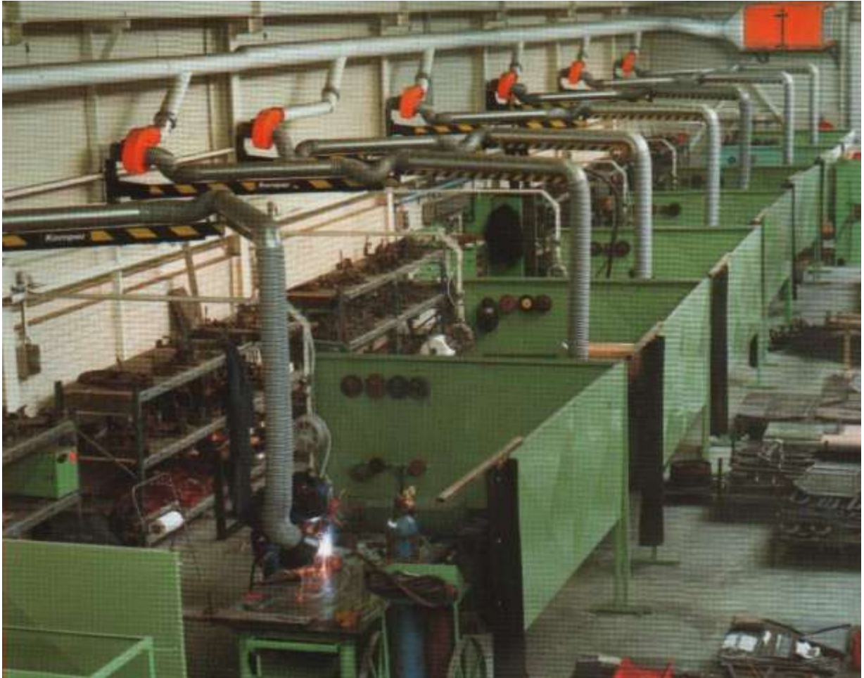
Obr. 135 Centrální odsávání exhalátů vzniklých při svařování z jednotlivých svářečských míst - svařovacích boxů
