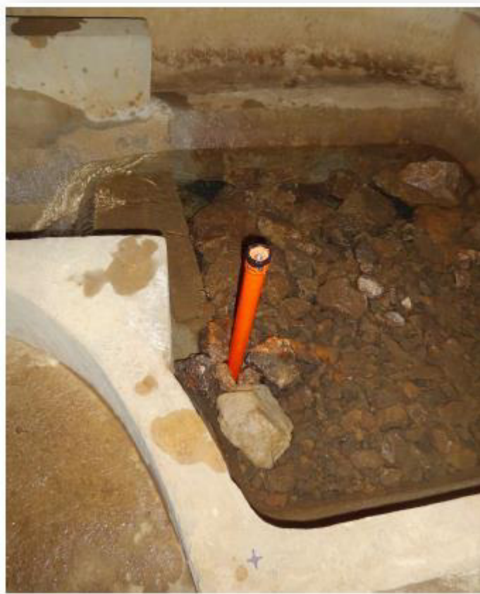
Fig. 4.10: Sensore di livello idrico e datalogger installato nella captazione della sorgente superiore, a monte della soglia di sfioro.
