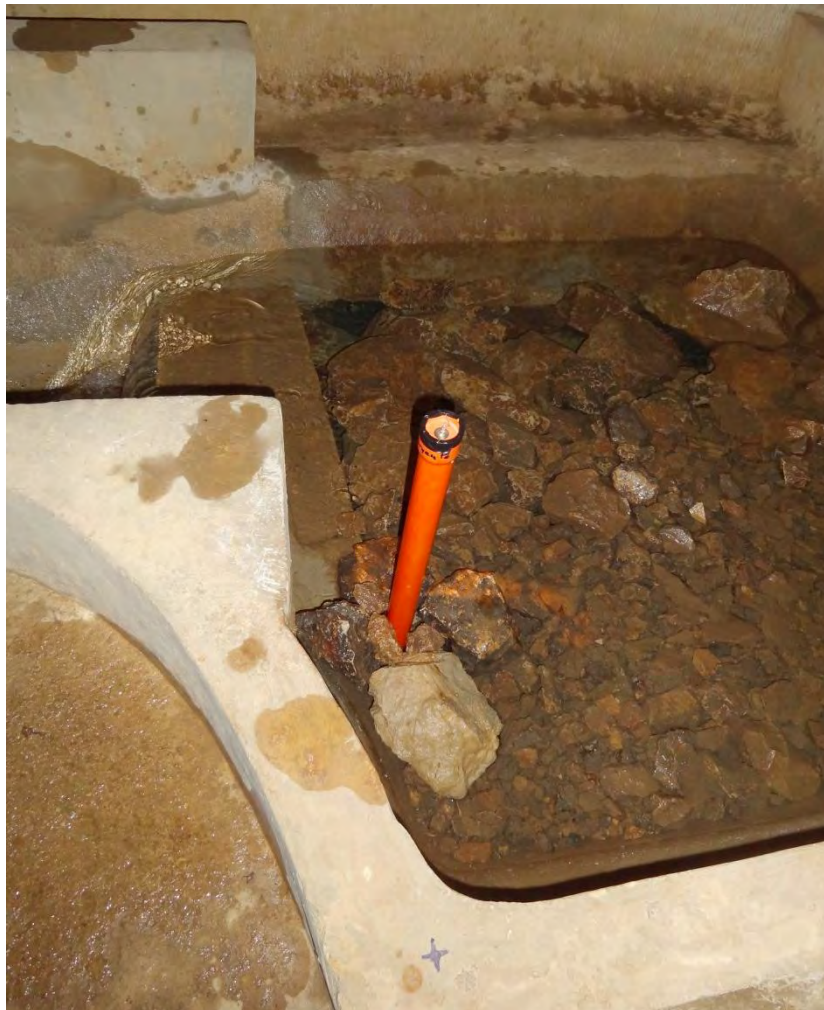
Fig. 5: Sensore di livello idrico e datalogger installato nella captazione della sorgente superiore, a monte della soglia di sfioro.
