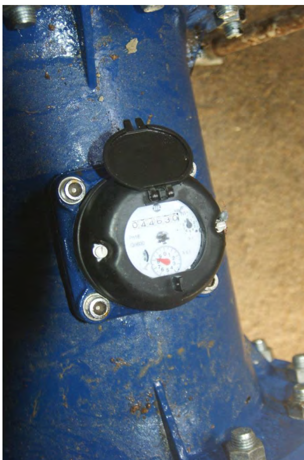
Fig. 6: Contatore installato sulla tubazione di adduzione al partitore. Le portate determinate dalle letture al contatore sono state utilizzate per validare le stime di portata effettuate mediante la trasformazione del livello idrico, misurato con i sensori/datalogger, in portata.
