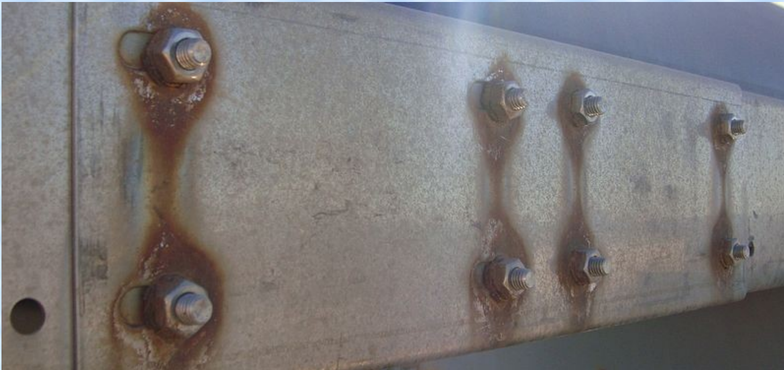
Galvanická koroze v místě kontaktu dvou různých kovů
