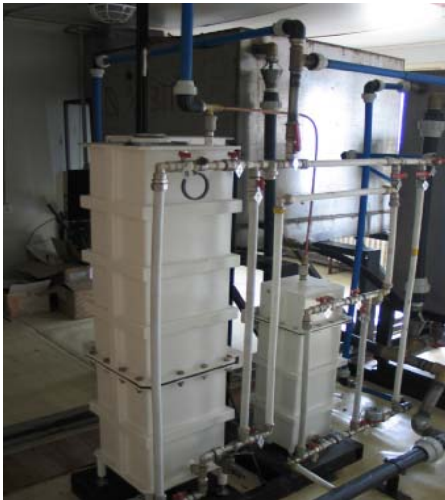
Рис. 4.1. Смонтированная в помещении комплекса «Лена» установка кондиционирования и очистки питьевой воды
