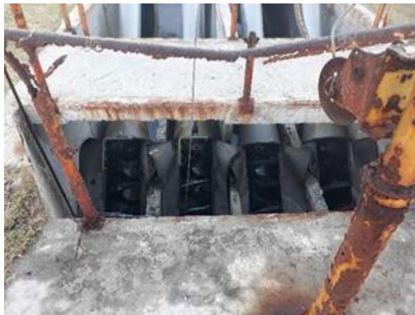
Figura 5- Estado Tornillo sin fin y barandas de protección
