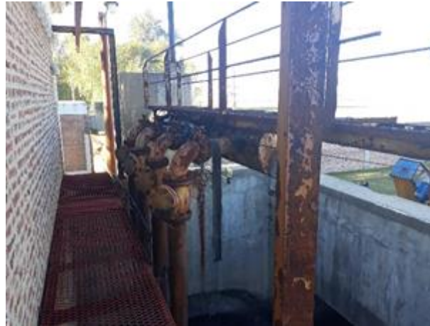
Figura 7- Estado de pasarela, barandas y colector
