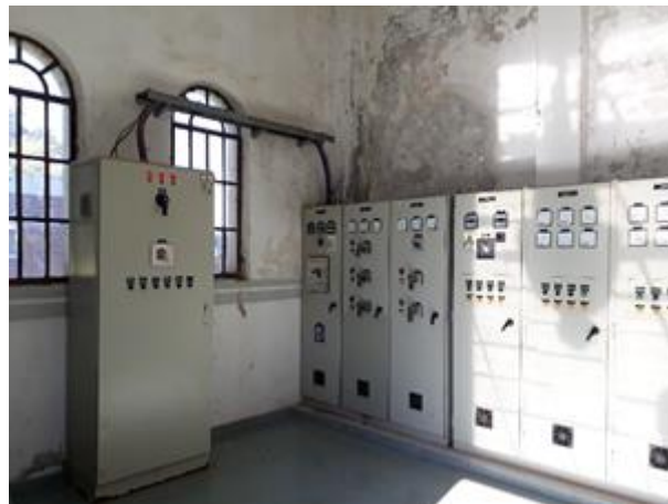
Figura 13- Sector de tablero generales de la planta
