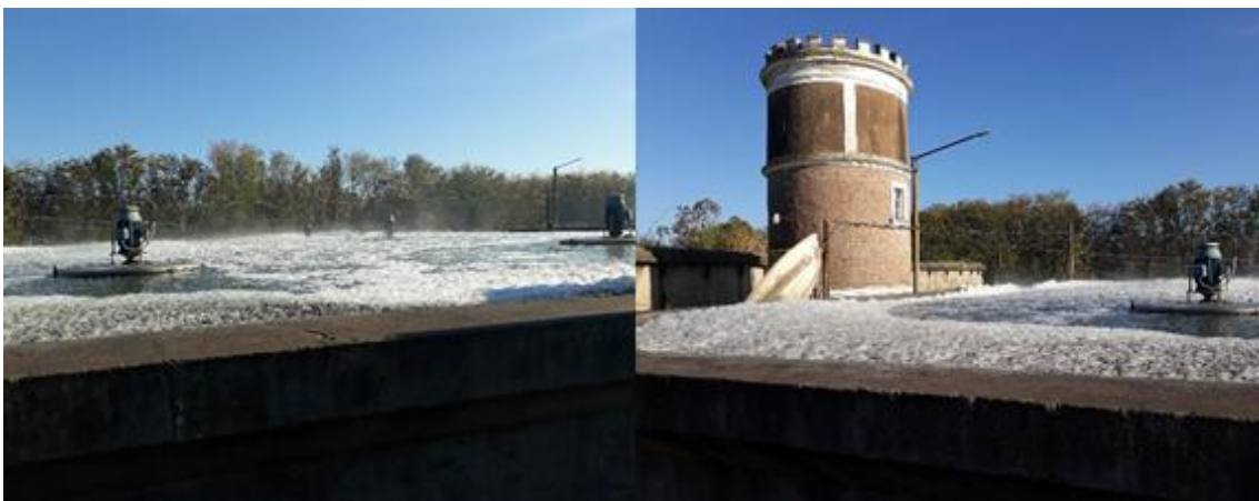
Figura 10 - Vista de condición de Reactor de mezcla completa
