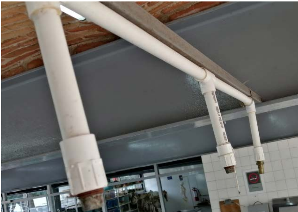
Imagen 16. Sistema de distribución de aire.
